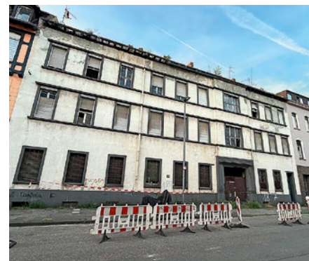
Die seit Jahren absolute Problem-Immobilie auf der Vennfelder Straße 45. Z.Zt. wegen herabfallender Gebäudeteile abgesperrt.
